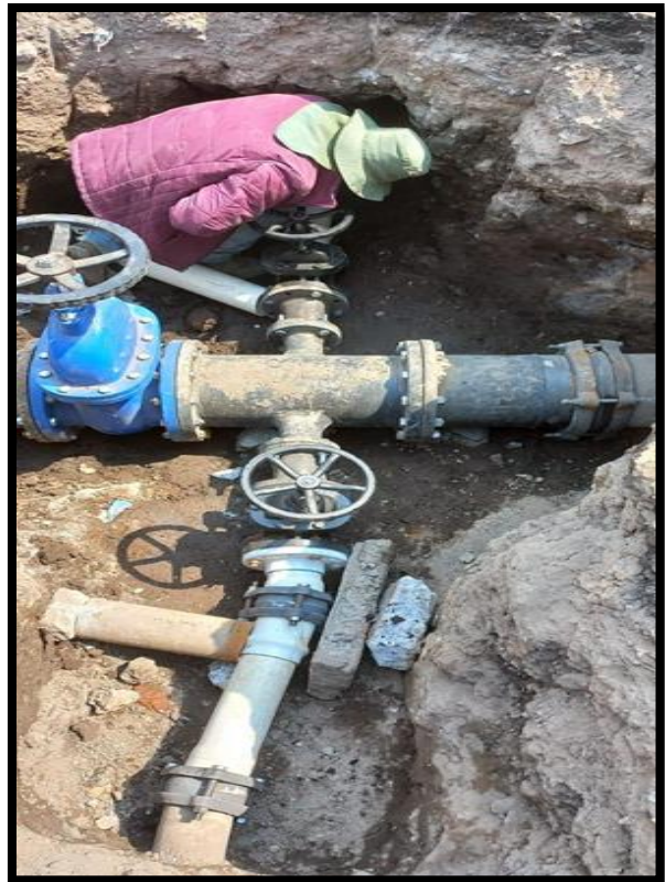
Cambio de válvulas de control y regulación de presión en redes hidráulicas.
