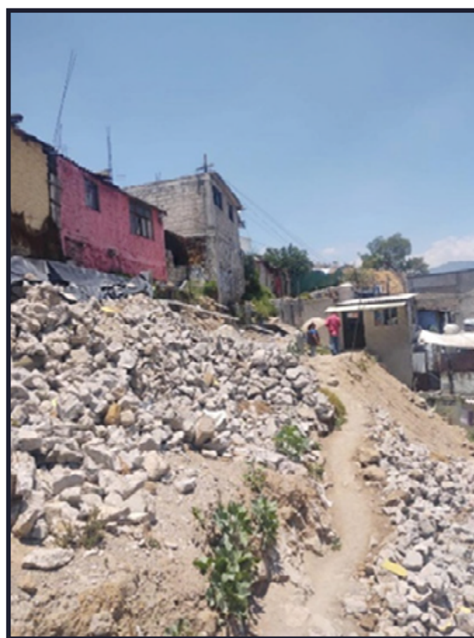
120 Colapso de muro de mampostería.
