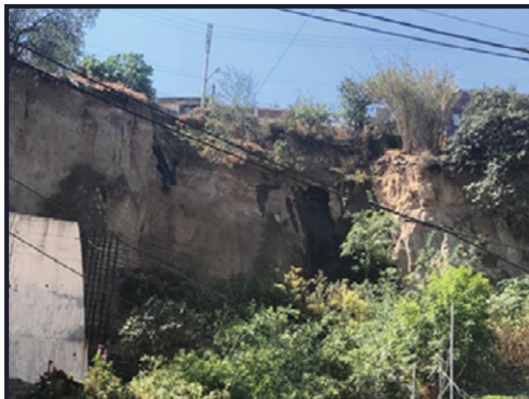
119 Talud en riesgo por humedad y deslizamientos.
