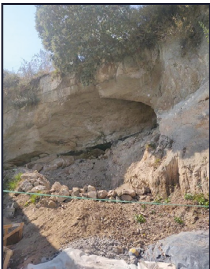
121 Talud con erosión por intemperismo.
