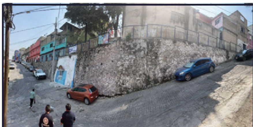
110 Talud con requerimiento de mantenimiento.
