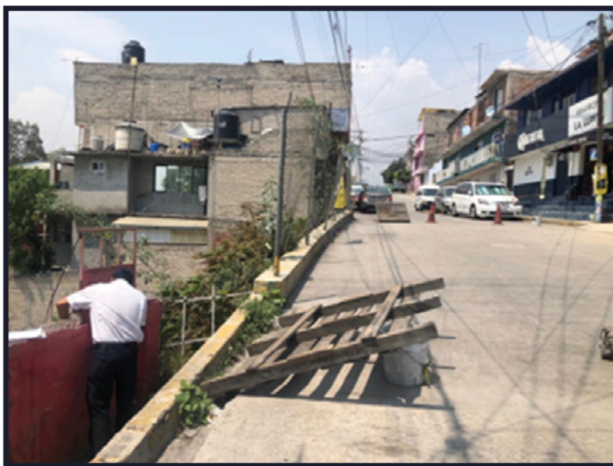
115 Talud con deslizamientos constantes.
