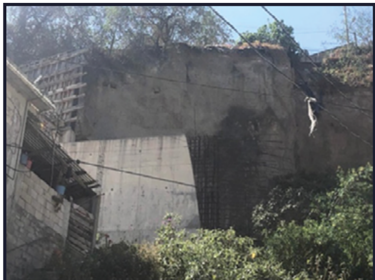
118 Talud con erosión y deslizamientos constantes.
