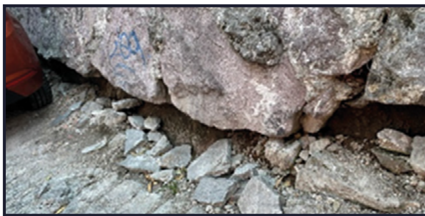
111 Talud con requerimiento de mantenimiento (2).
