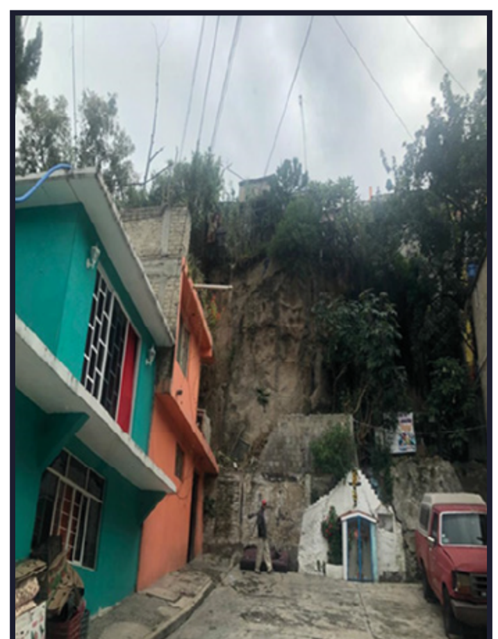
117 Talud con humedad y vegetación con presencia de deslizamientos.
