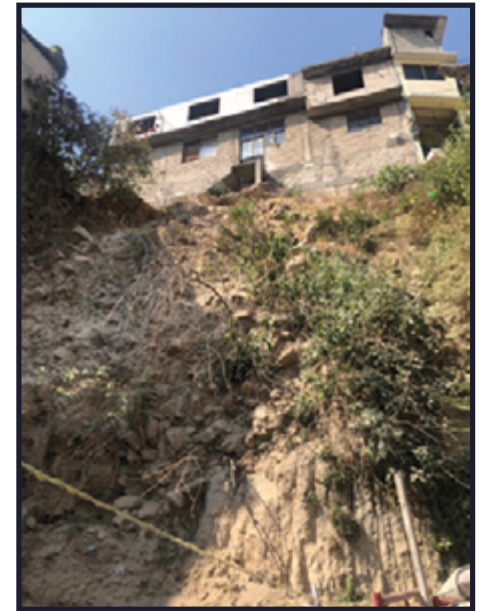
114 Talud con erosión.
