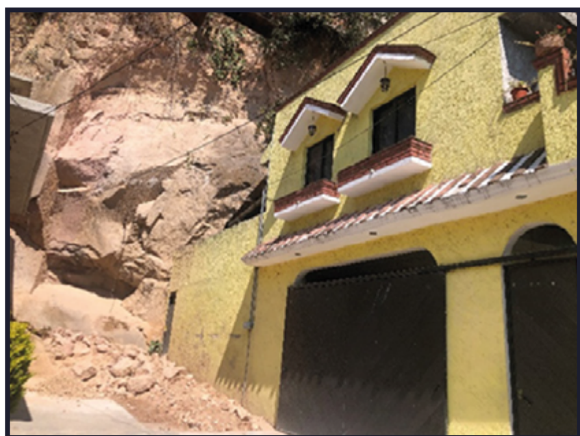
112 Talud en mal estado.
