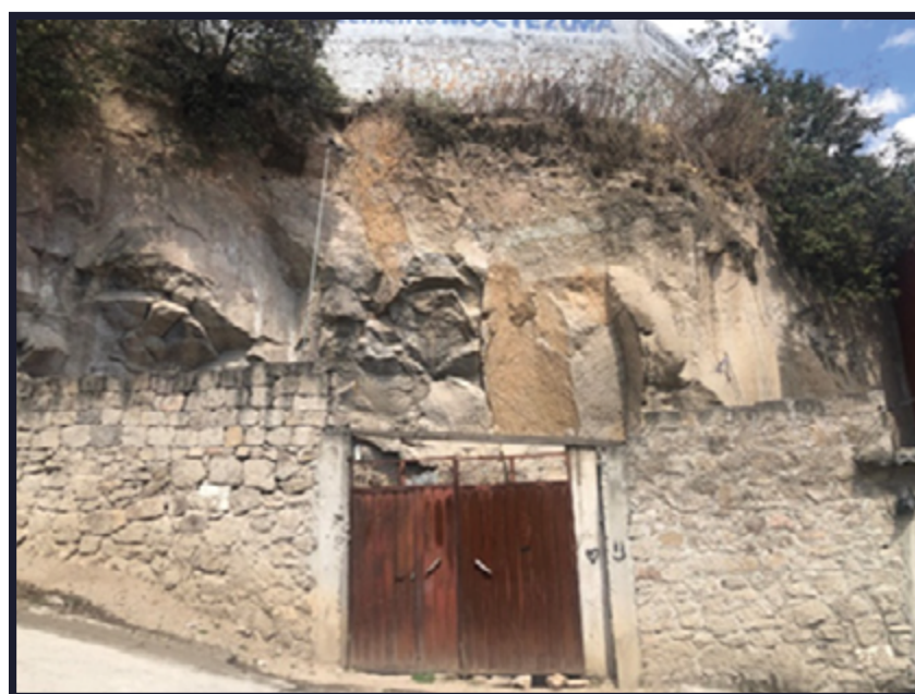
113 Talud con riesgo de caídos.
