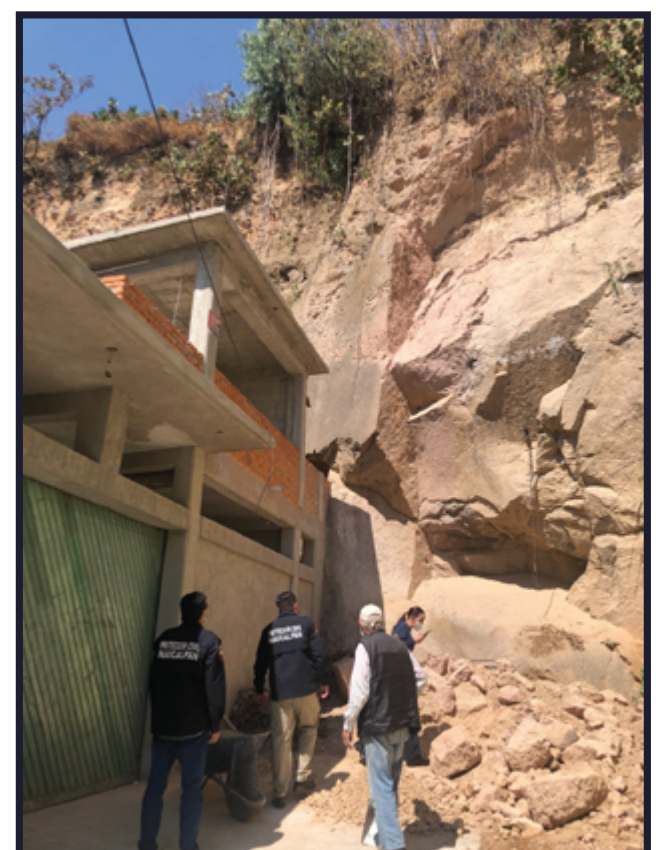
53 Ejemplo de Talud con caídos de rocas.
