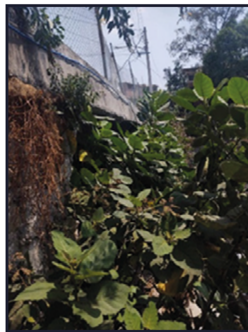
116 Talud con deslizamientos.
